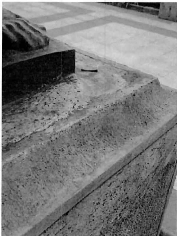
Chorro de óxido sobre pedestal
