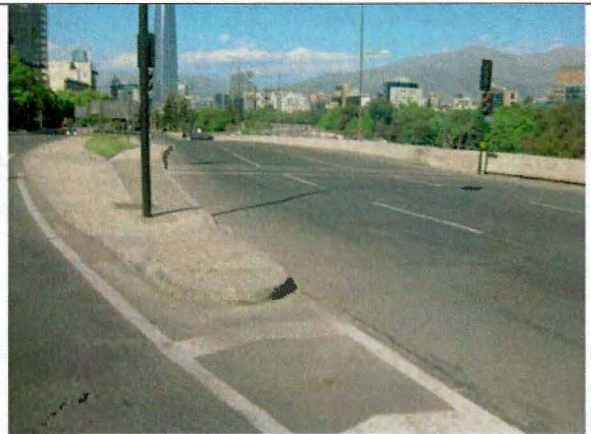
Apreciando hacia vista oriente, se identifica cierta deformidad en la nivelación del pavimento por ahuellamiento leve en superficie.
