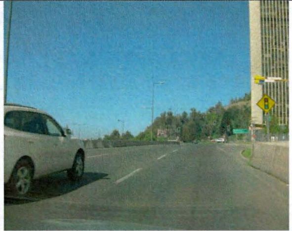
Grietas transversales en zonas puntuales.
