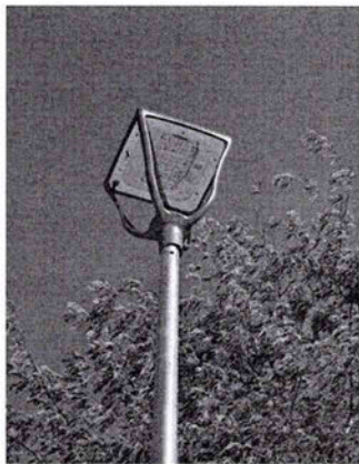
Imagen N°3 Luminaria en poste cónico galvanizado
