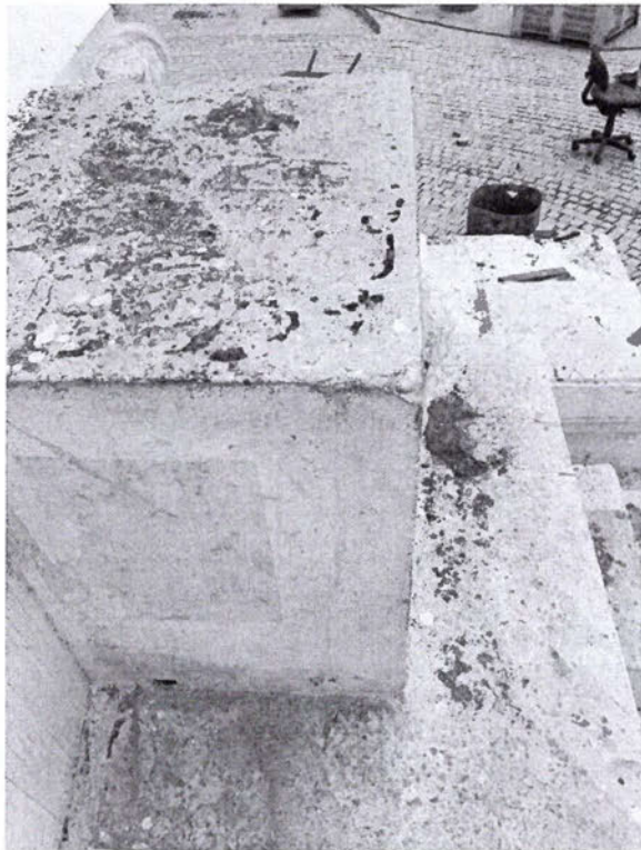
Figura 32: Foto suciedad superficial del plinto. Fuente: Municipalidad de Providencia.
