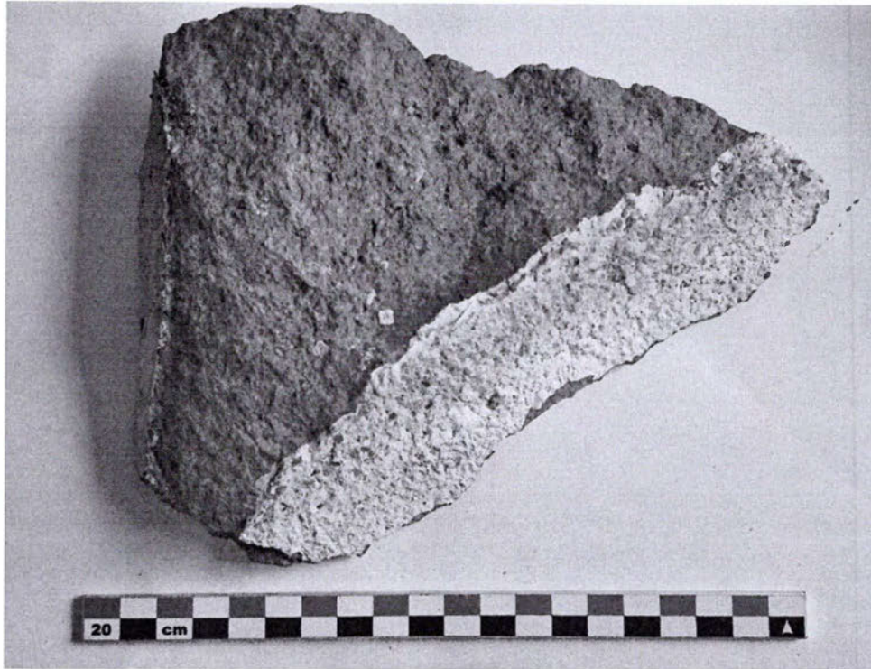
Figura 19: Fotografía lugar de piedra desprendida. Fuente: Municipalidad de Providencia.
