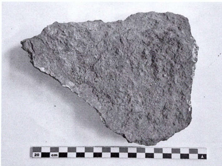
Figura 20: Fotografía lugar de piedra desprendida. Fuente: Municipalidad de Providencia.
