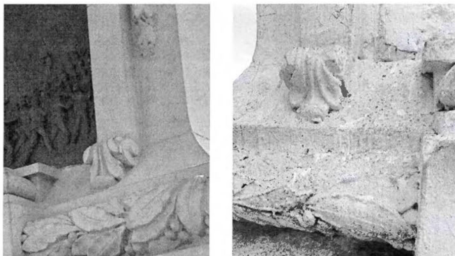
Figura 41: En imagen izquierda fotografía de ornamentación 2018 y en fotografía derecha ménsula con daños 2025. Fuente: Municipalidad de Providencia.
