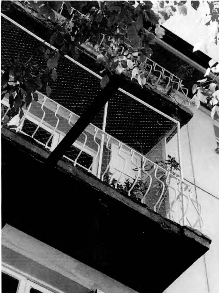
Figura 12: Desprendimiento de recubrimiento de hormigón en losas de balcones de fachada sur.
