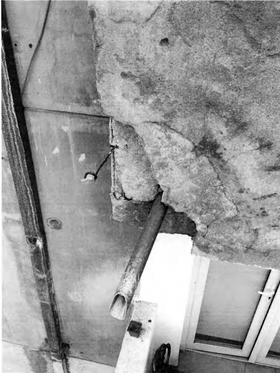
Figura 19: Desprendimiento de hormigón en balcón interior.
