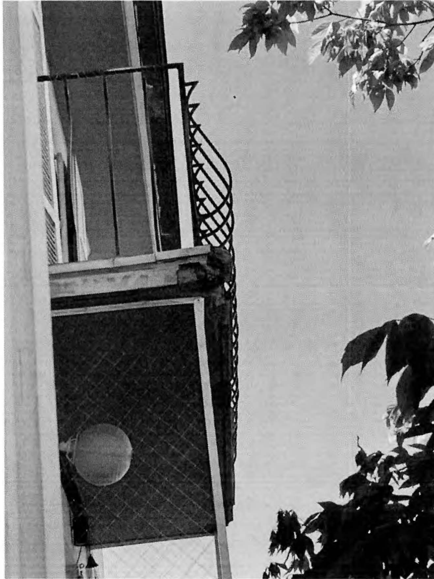
Figura 8: Daño por desprendimiento en losa de balcones, en fachada sur.
