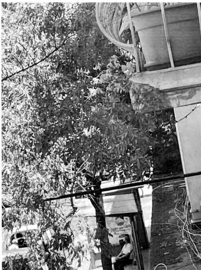
Figura 10: Daño típico en losa de balcones en fachada sur.
