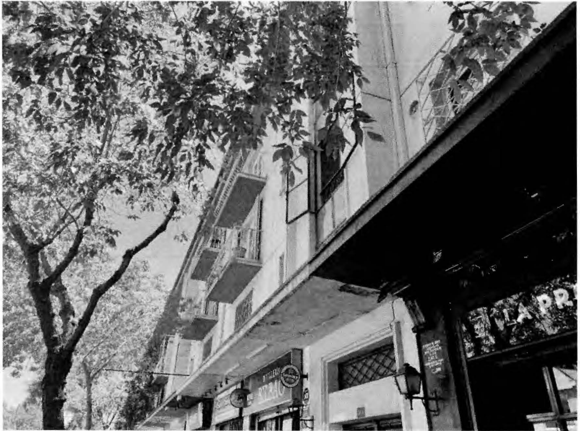
Figura 11: Fisuramiento típico en recubrimiento de marquesinas de fachada sur.
