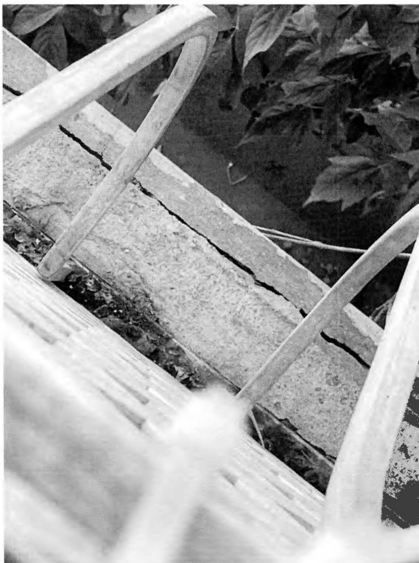
Figura 7: Fisuras en losa de balcones en fachada sur.
