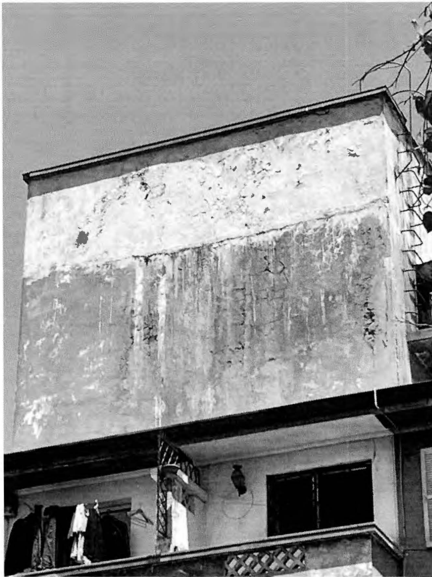
Figura 17: Fisuramiento y soplado de estucos en estanque de agua y aleros de patio interior, fachada norte.
