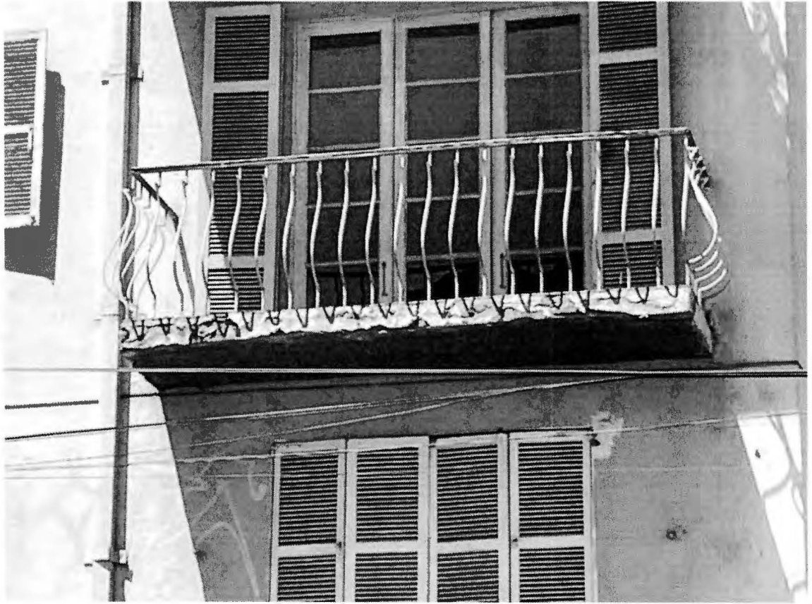
Figura 14: Desprendimiento de hormigón en losas de balcones fachada oeste.
