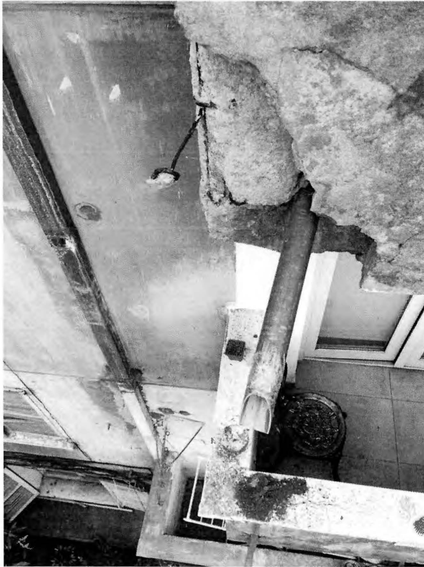
Figura 20: Desprendimiento de hormigón en balcón interior y bajada de aguas lluvias a reemplazar.
