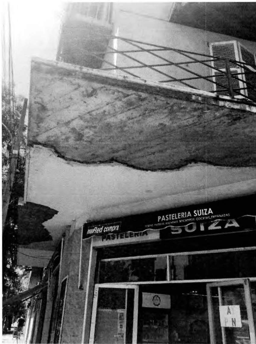
Figura 13: Desprendimiento en marquesina fachada sur con fachada oeste.
