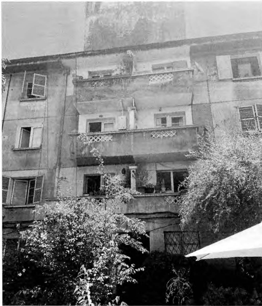
Figura 22: Cubeta y bajada de aguas lluvias a cambiar
