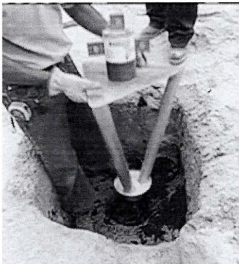
INSTALACIÓN TIERRA MAGNETOACTIVA
