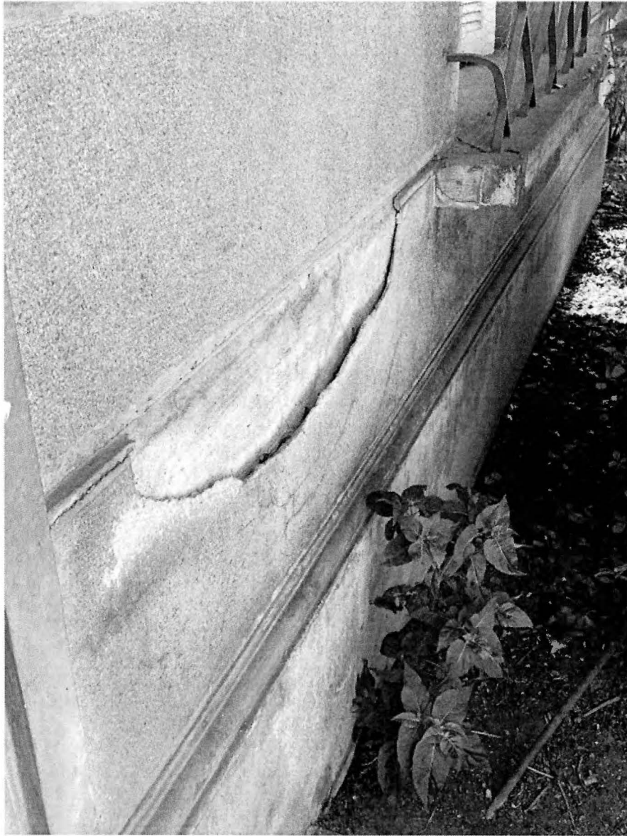
Figura 17: Desprendimiento de planchas de estuco de terminación en fachada sur.
