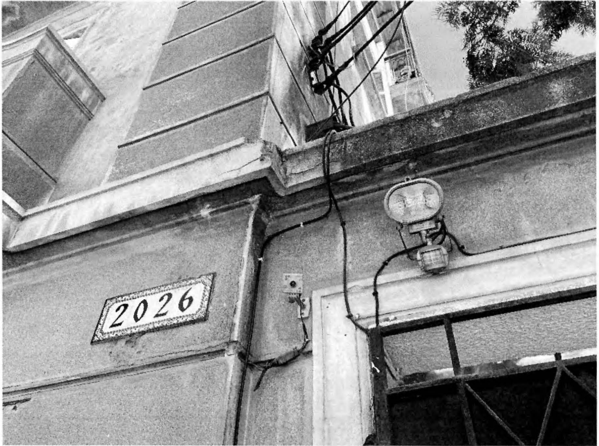
Figura 23: Desprendimiento de revestimiento en alero de acceso de edificio, fachada este.
