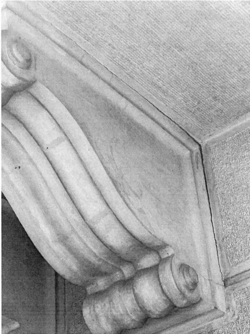
Figura 19: Fisuras en elementos ornamentales en fachada sur.
