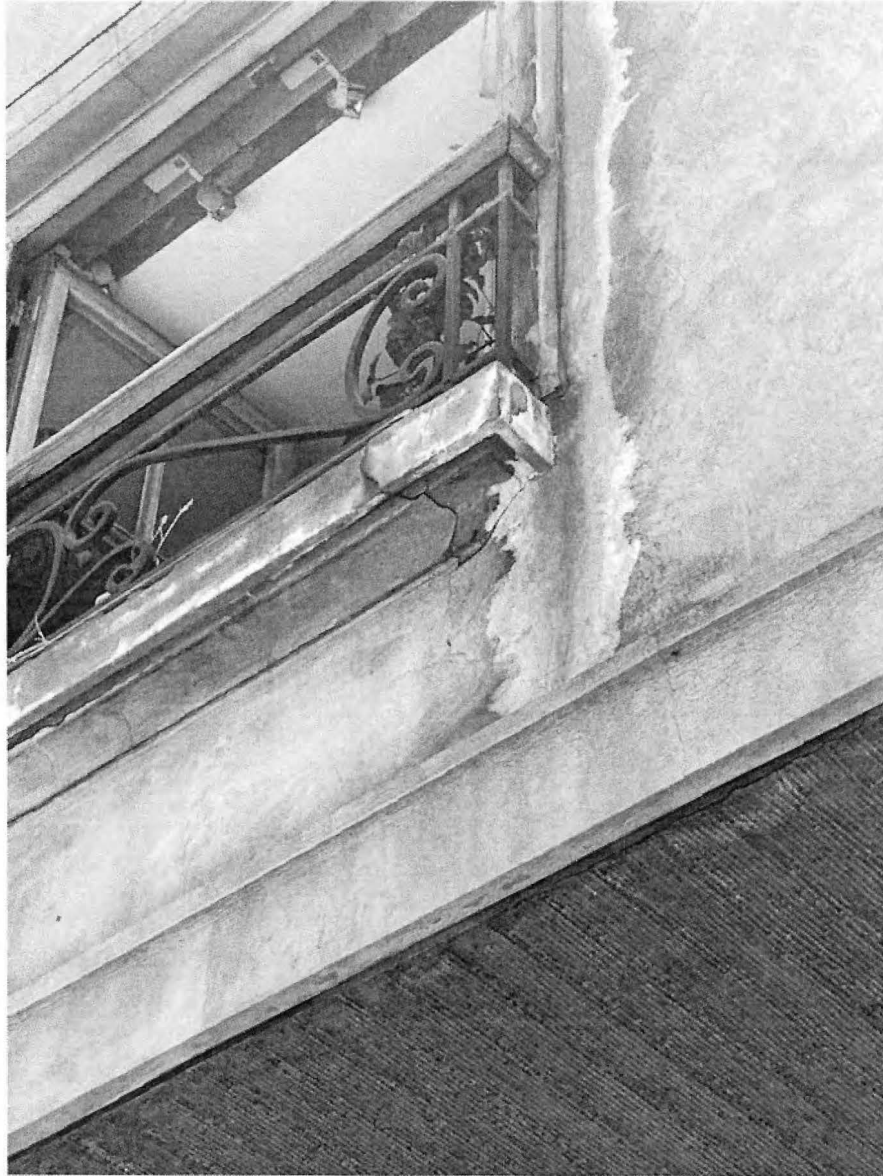
Figura 18: Fisuras en marquesinas de ventanas típico en fachada sur.
