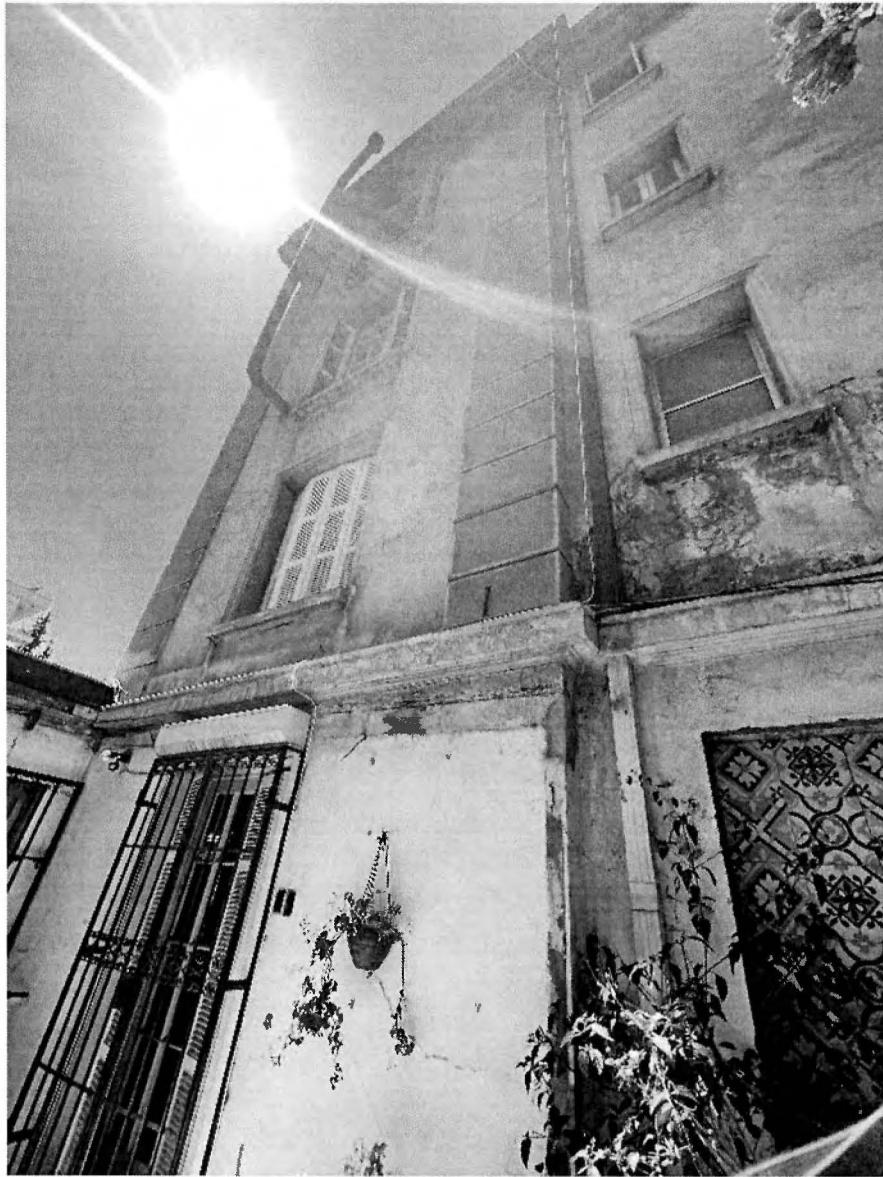
Figura 25: Fisuras y estucos sueltos en fachada norte, patio interior.
