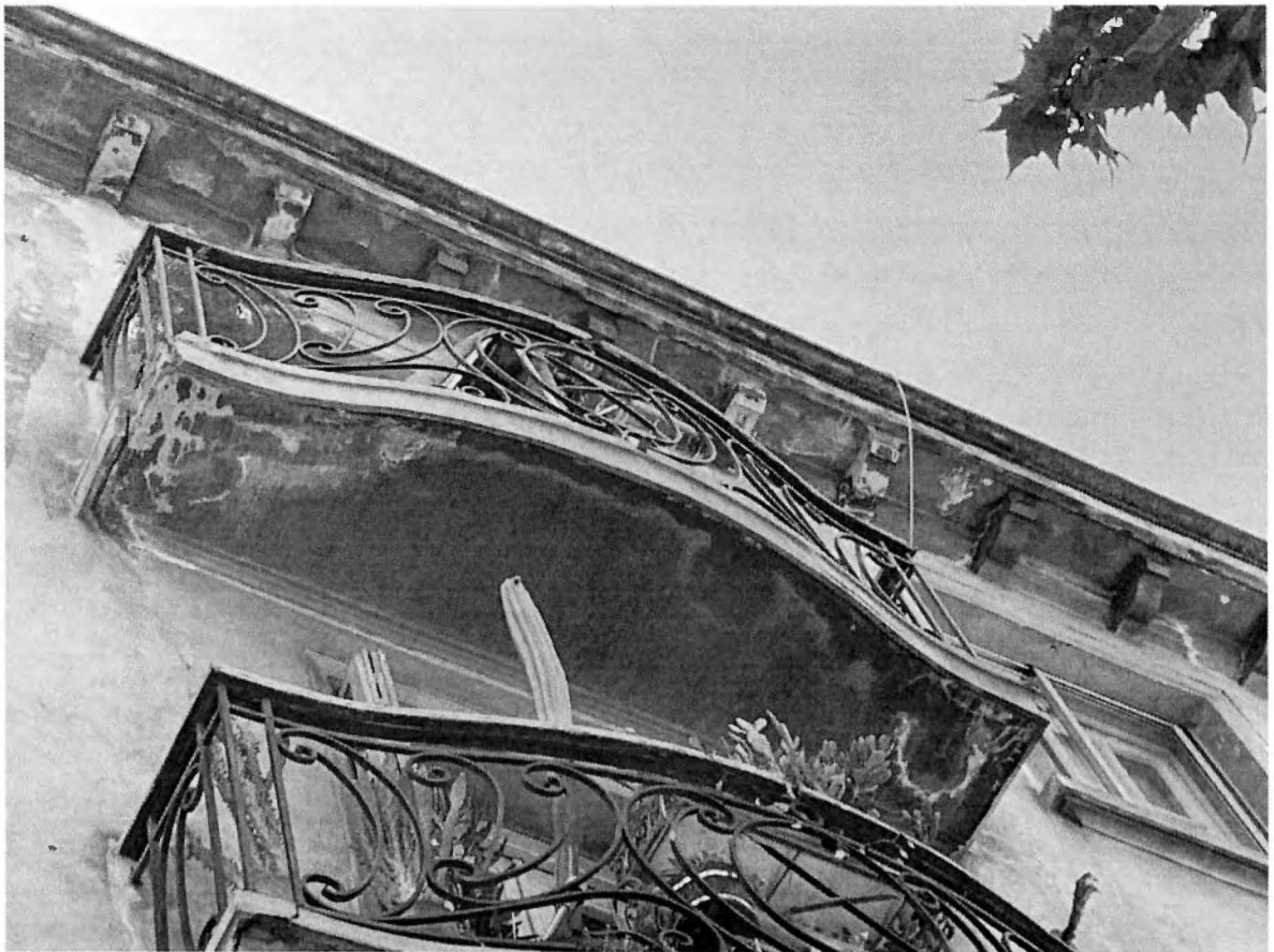
Figura 8: Daño típico desprendimiento de hormigón de recubrimiento lateral en losas de balcones, fachada oeste.
