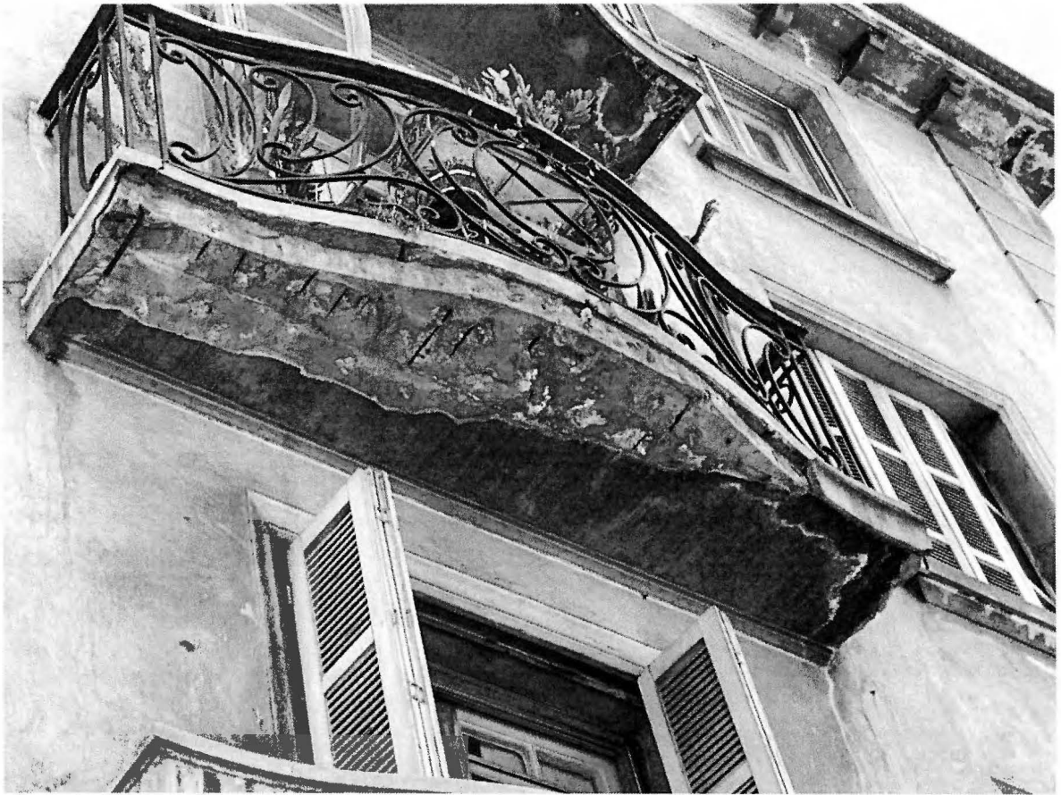
Figura 7: Daño típico desprendimiento de hormigón de recubrimiento en losas de balcones, fachada oeste.
