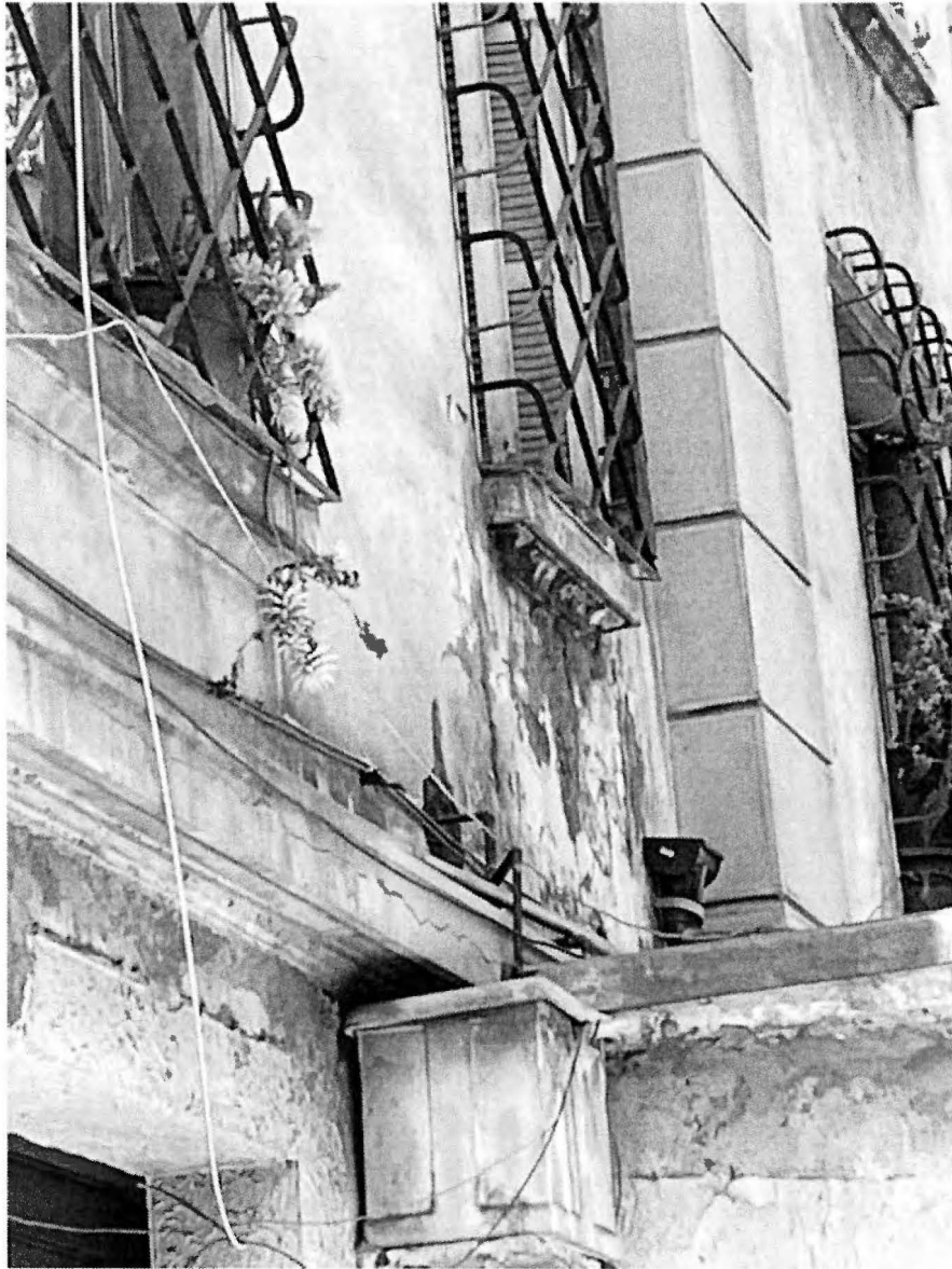
Figura 29: Fisuras en muros y aleros en fachada norte, patio interior.
