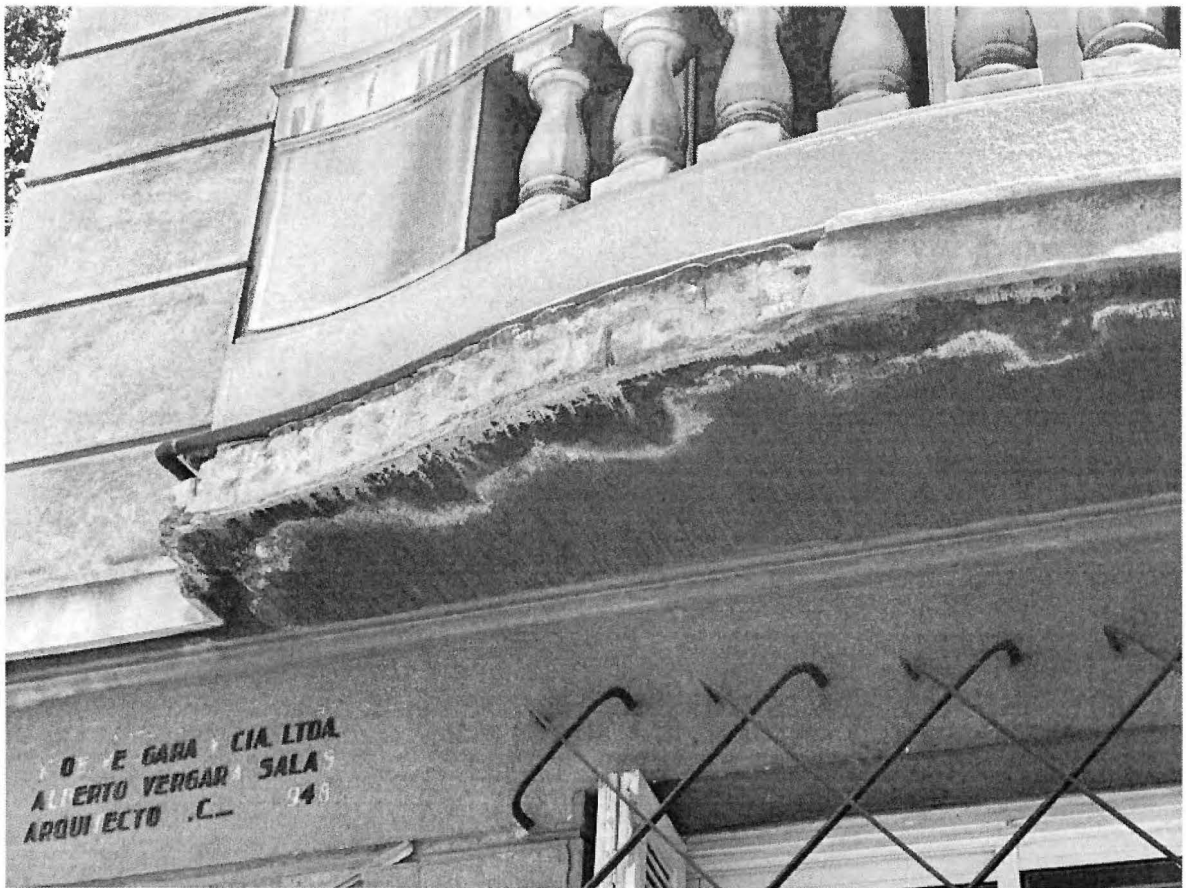
Figura 12: Detalle de desprendimiento en balcones de fachada sur.
