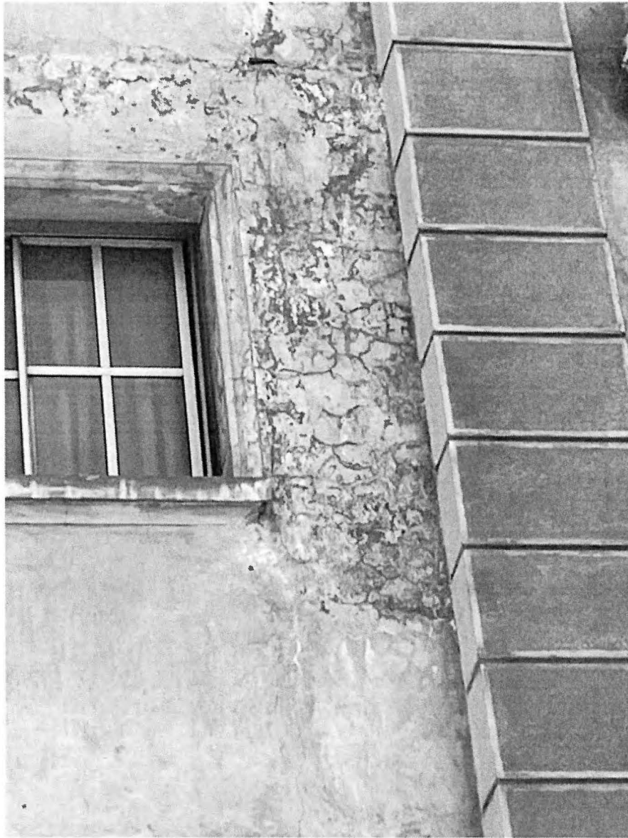
Figura 21: Fisuras en muros de fachada sur.
