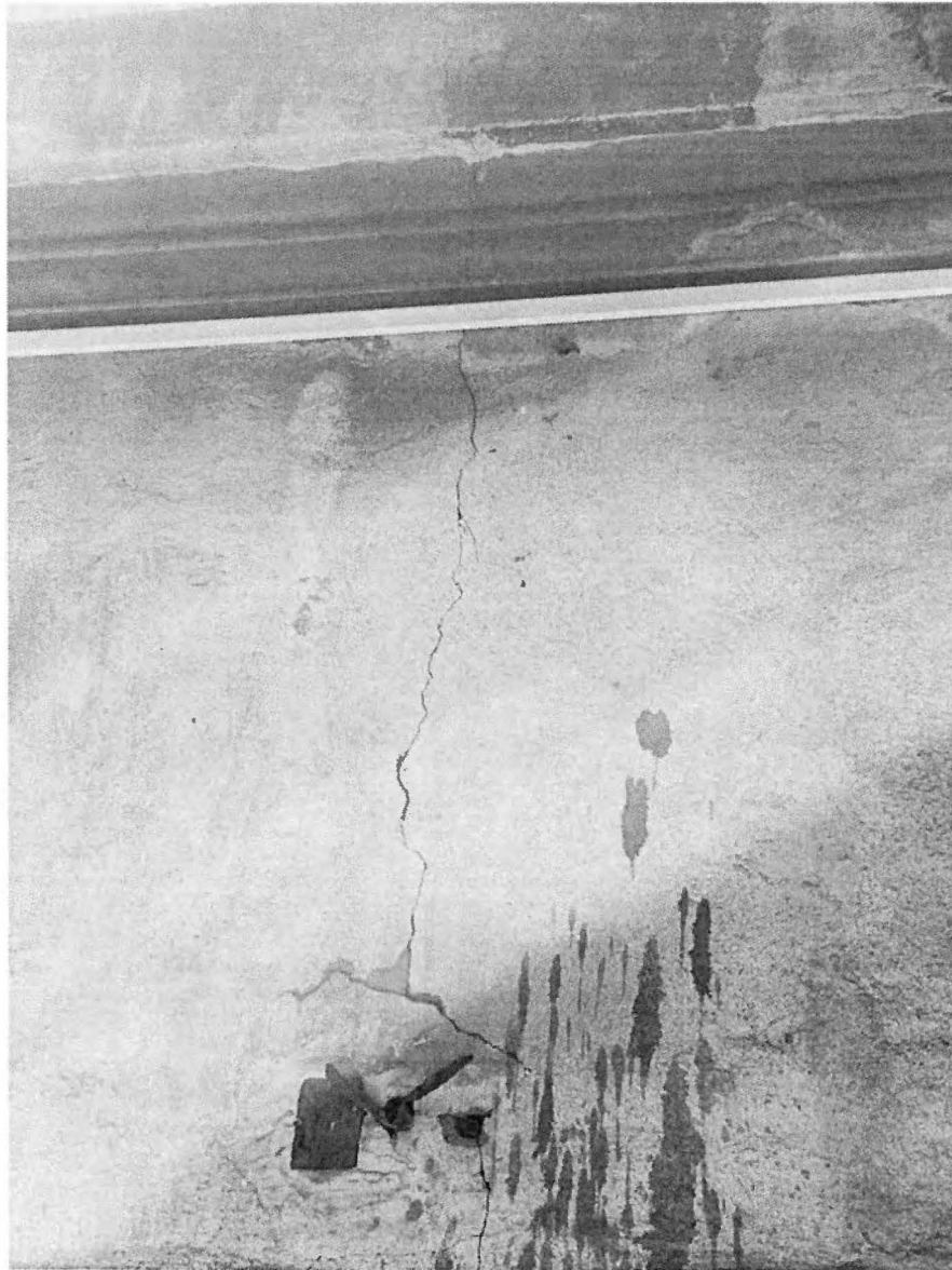
Figura 28: Fisuras en muros en fachada norte, patio interior.
