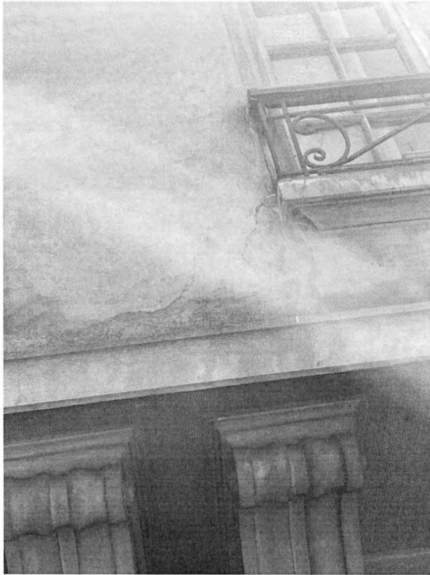
Figura 16: Fisuras en muros de fachada sur.
