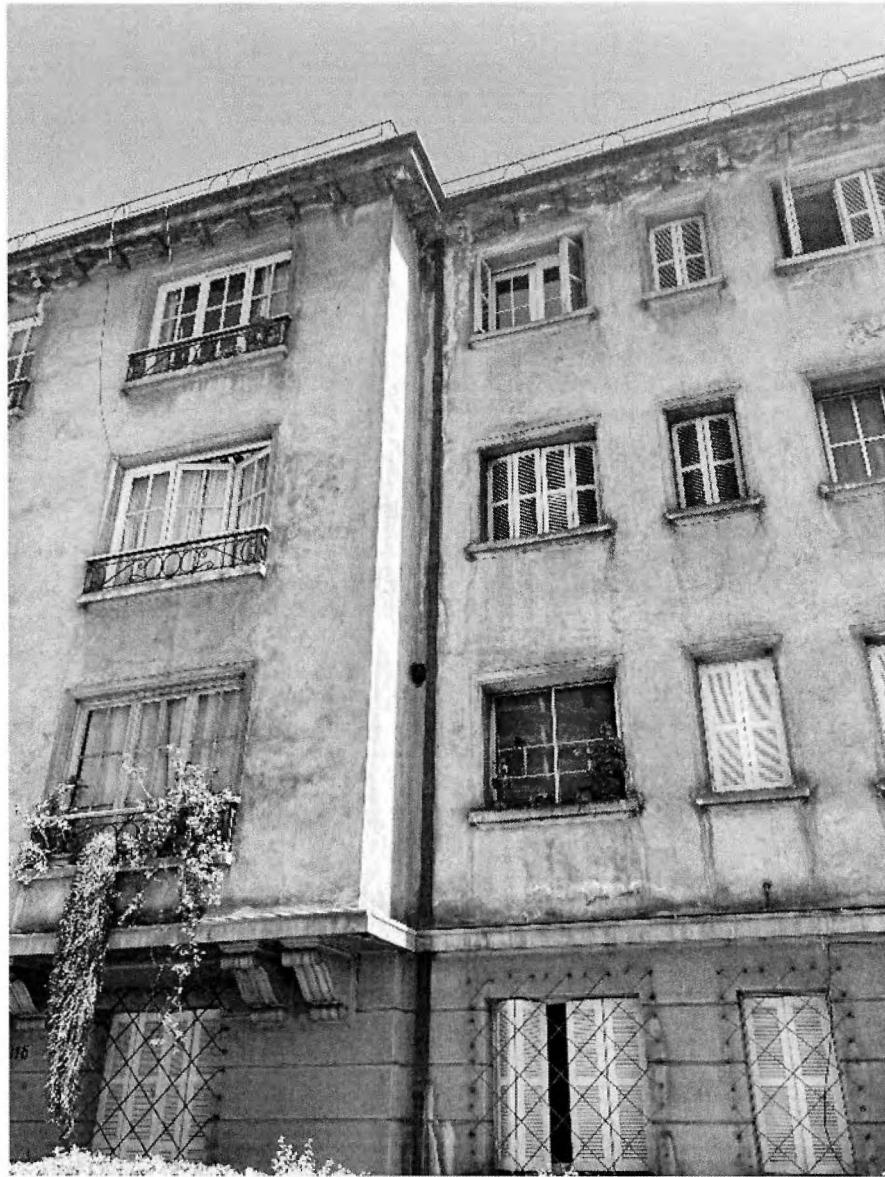
Figura 20: Fisuras en muros por daños en aguas lluvias, daños por humedad, en fachada sur.
