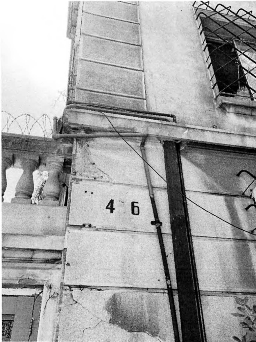
Figura 9: Daño por fisuramiento y desprendimiento de revestimiento en muro fachada oeste.
