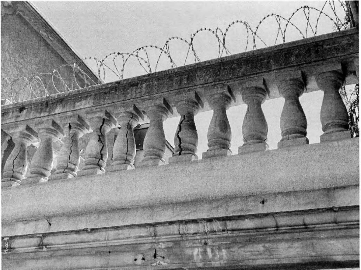
Figura 10: Daño por fisuramiento en balaustas de fachada oeste.
