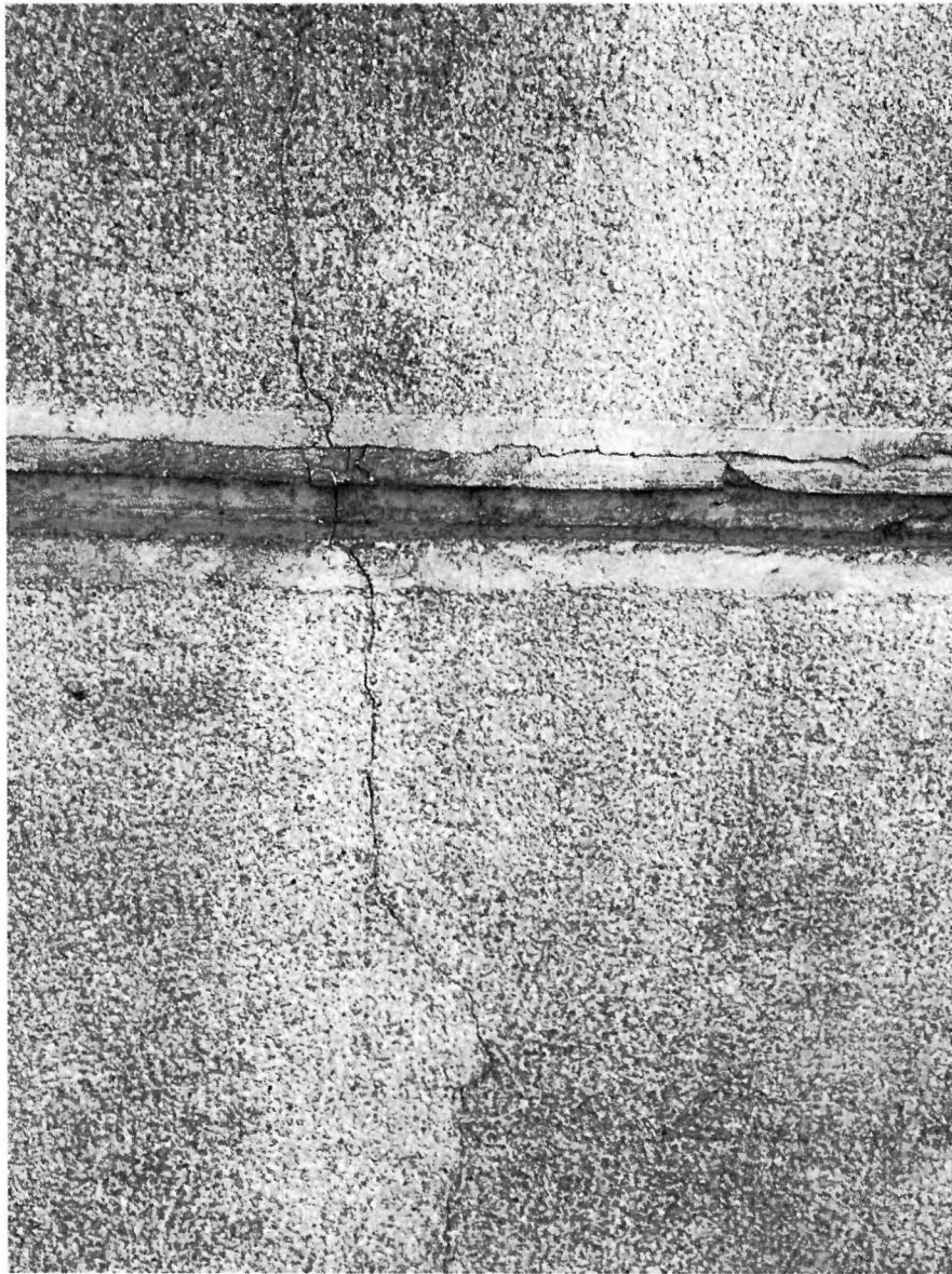
Figura 14: Fisura en revestimientos de estucos de muros, fachada sur.
