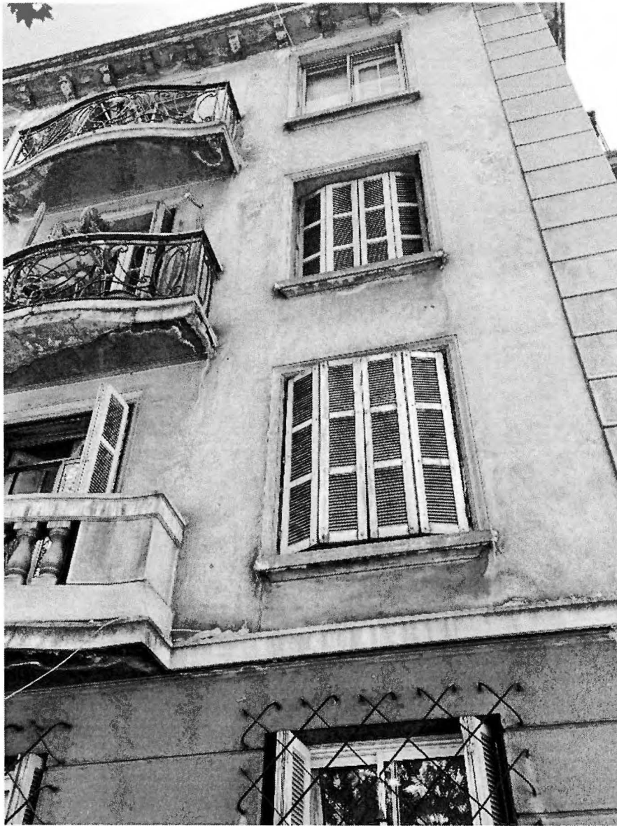
Figura 6: Daño típico fisuras en muros y marquesinas de ventanas, fachada oeste.
