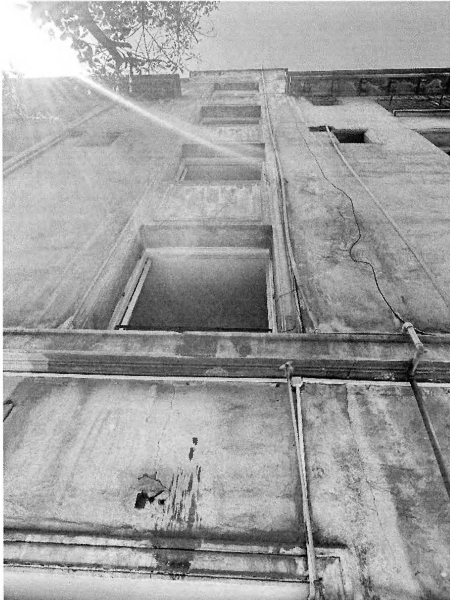
Figura 27: Fisuras en ventanas y muros en fachada norte, patio interior.
