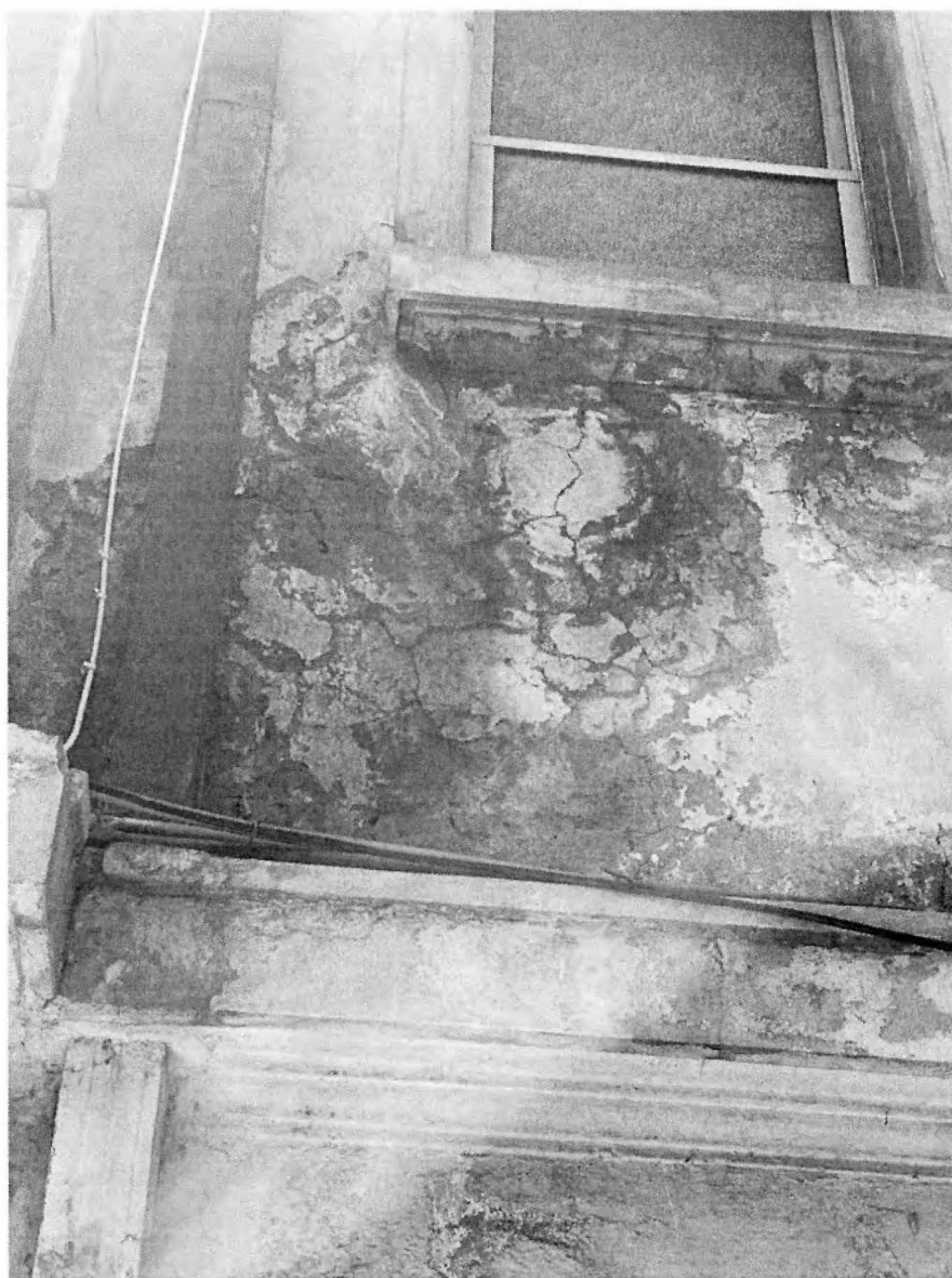
Figura 24: Fisuras y estucos sueltos en fachada este.
