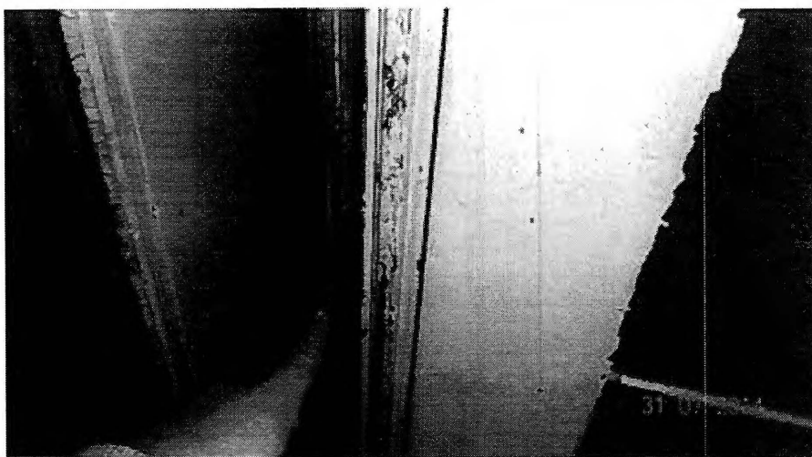
Sistema de reapertura por impacto en puertas de cabina se encuentra desajustado.
