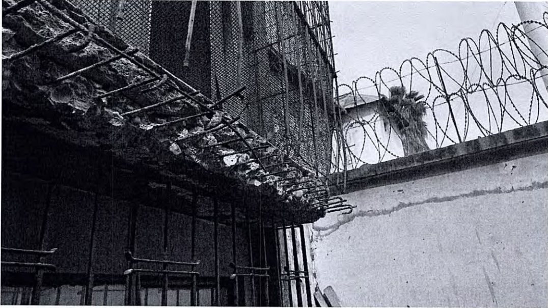
Figura 6: Desprendimiento de hormigón en losa de balcones sector poniente.
