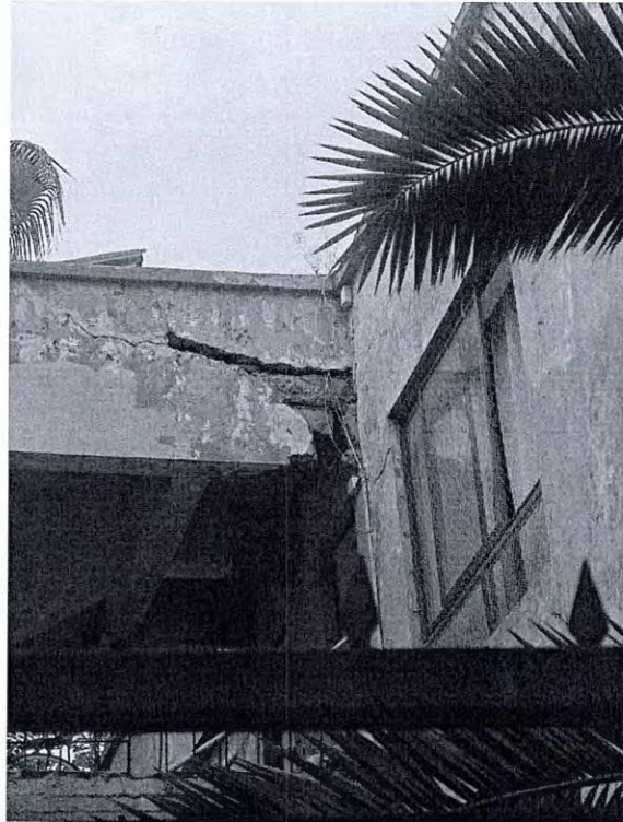
Figura 3: Desprendimiento de apoyo de vigas y losa en caja escala
