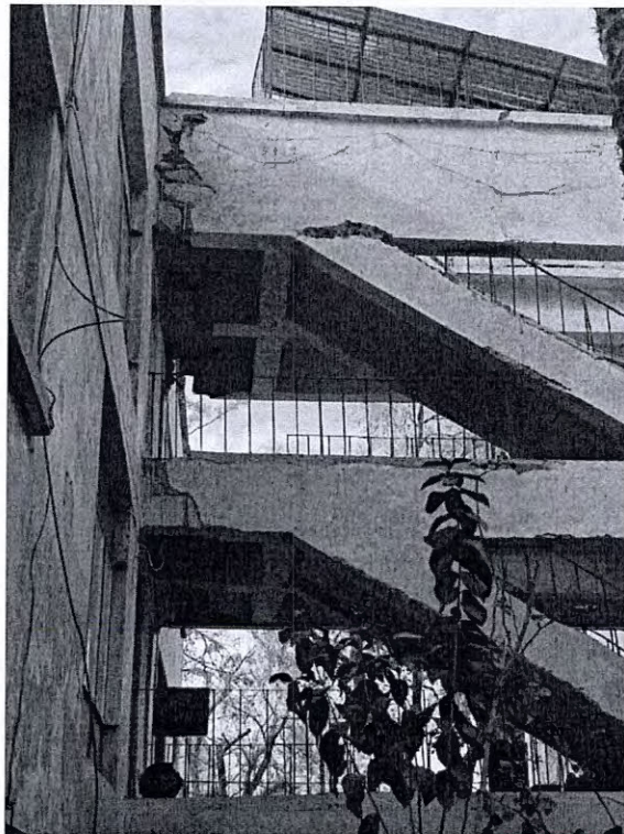
Figura 4: Desprendimiento de apoyo de vigas y losa en caja escala
