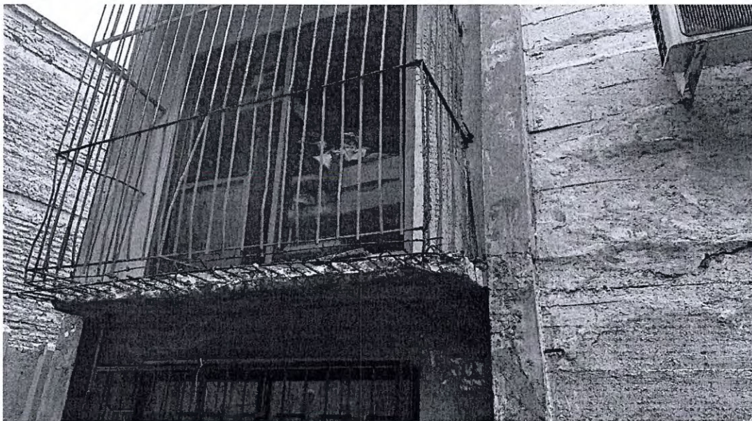
Figura 5: Desprendimiento de hormigón en losa de balcones sector oriente.
