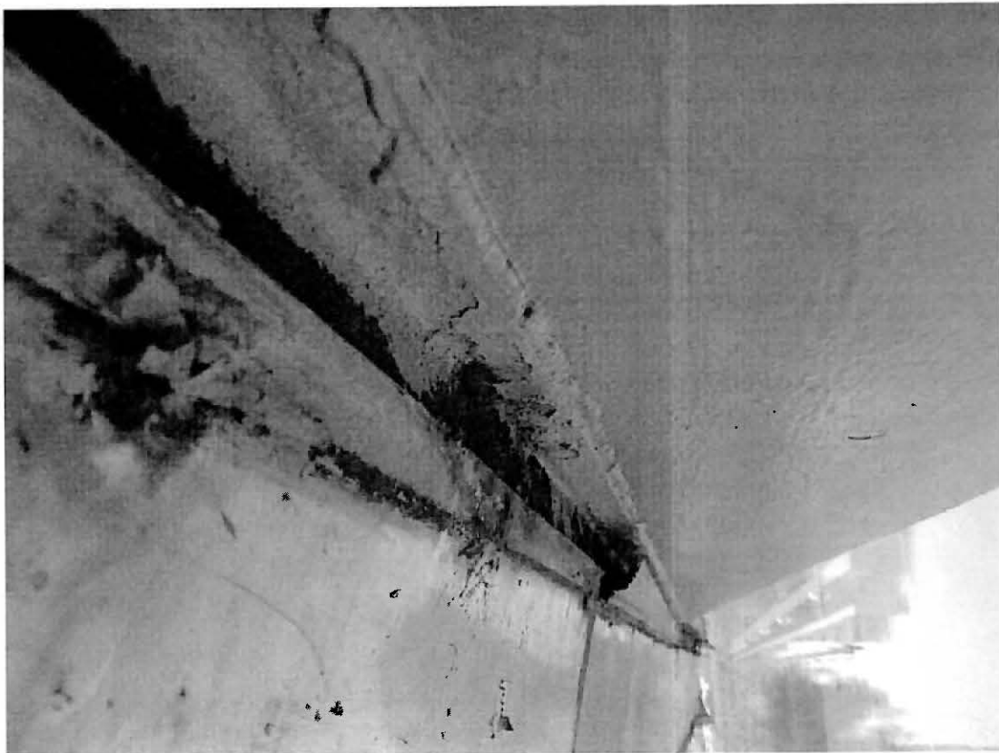
Figura 11: Oxidación en perfil ángulo de montaje.
