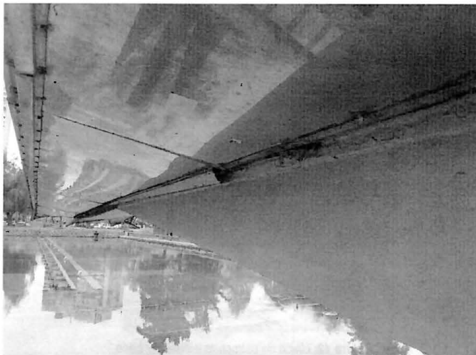
Figura 10: Oxidación en perfil de montaje de plancha.
