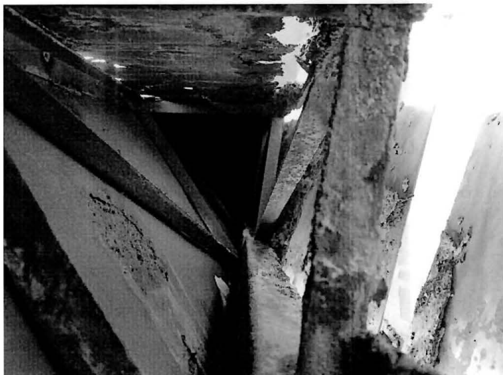
Figura 8: Oxidación en cola del monumento. La oxidación está afectando la sección de los perfiles del reticulado.
