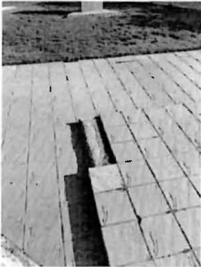
Faltante de palmetas en terrazas circundantes
