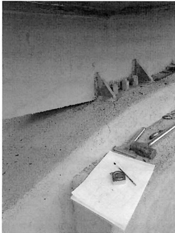
Figura 13: Grieta en unión con la base. Revestimiento de litofren se encuentra soplado.
