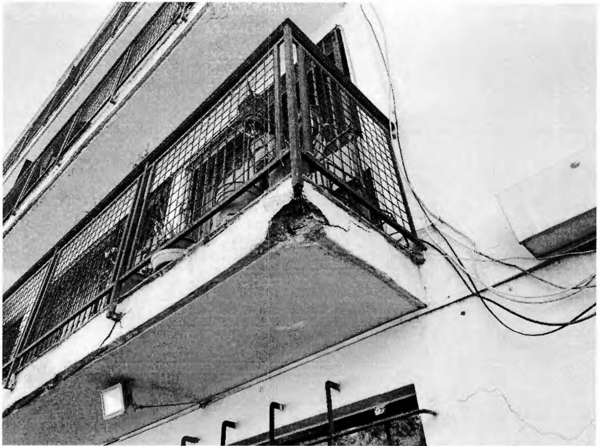
Figura 13: Desprendimiento en losa de balcones de fachada oeste.
