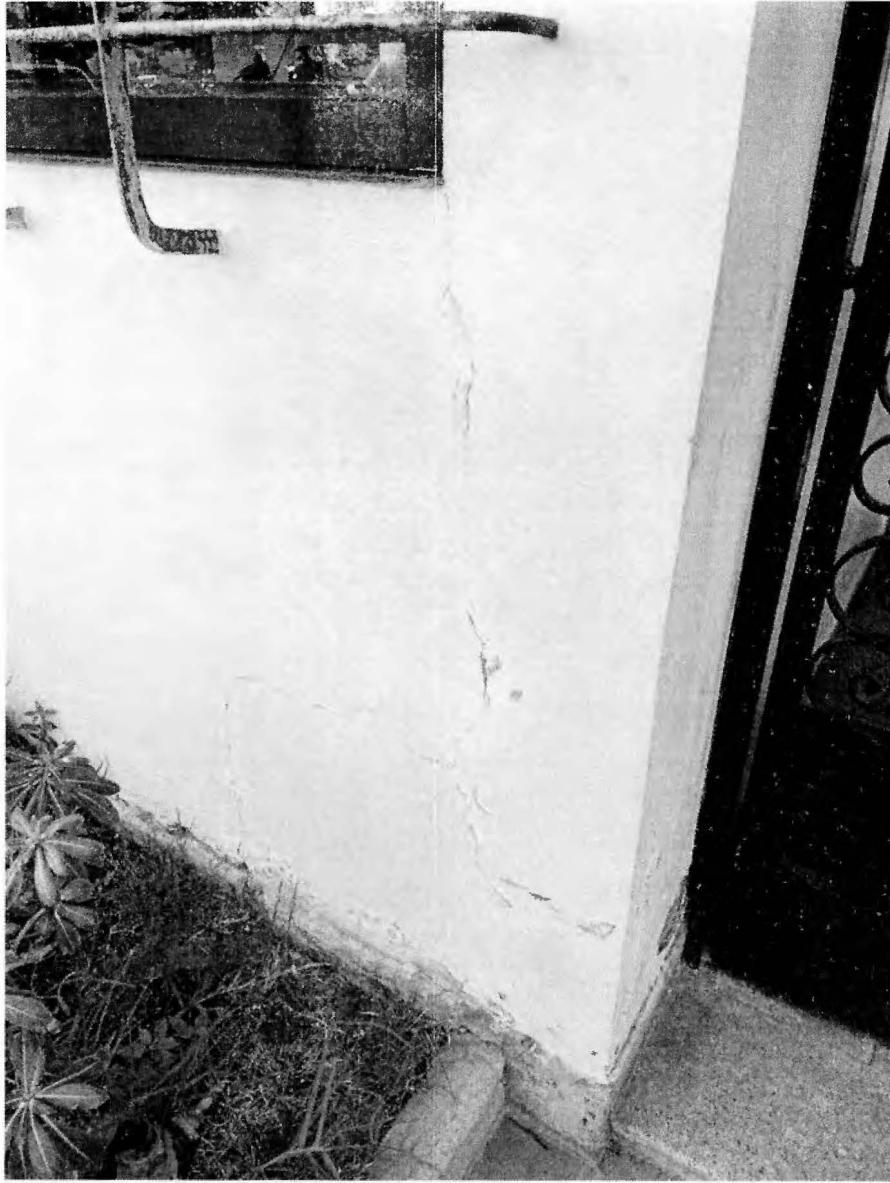
Figura 11: Fisuramiento típico en recubrimiento de estuco en muro de fachada oeste.
