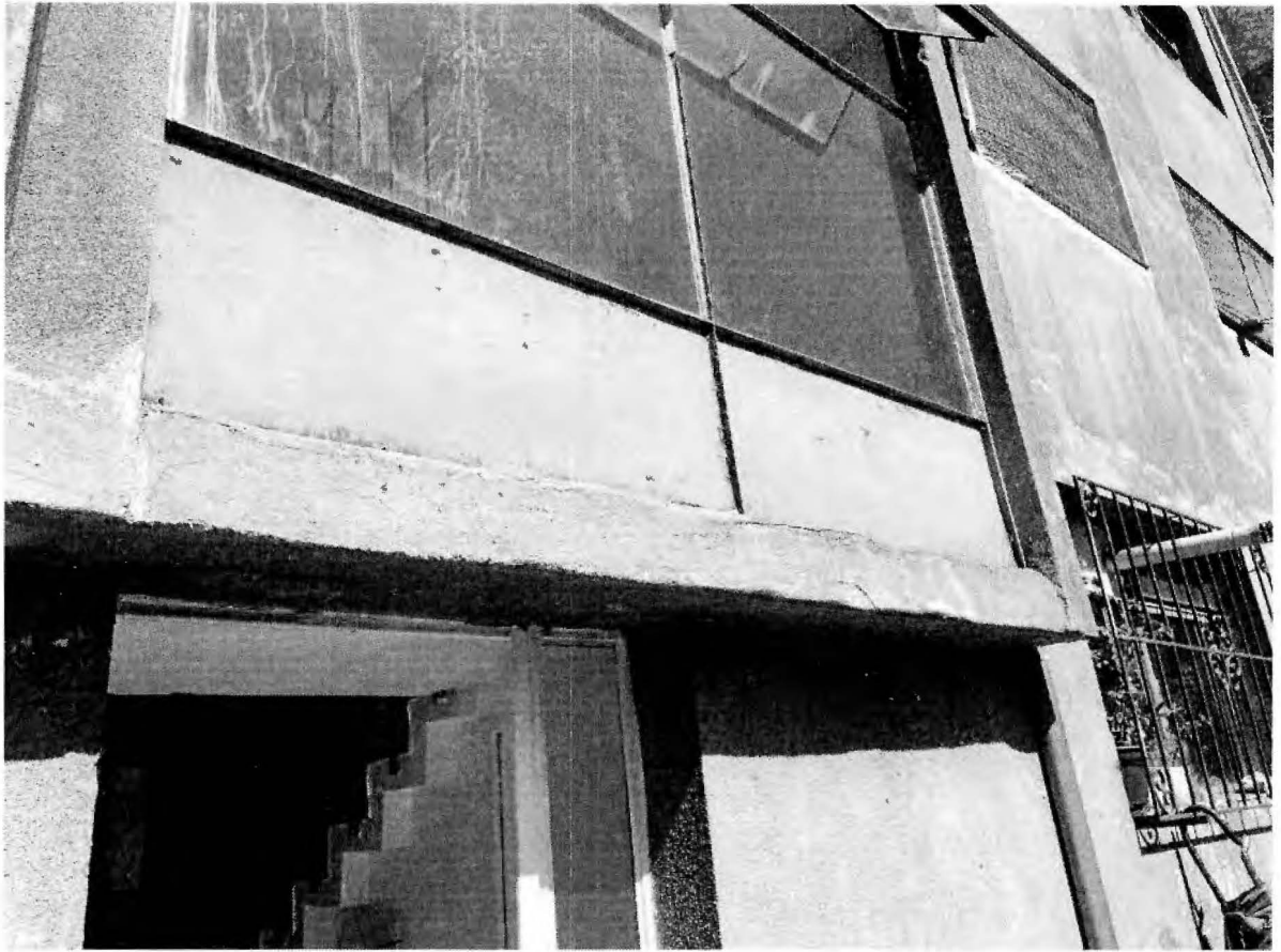
Figura 7: Fisura en alero de acceso a patio interior
