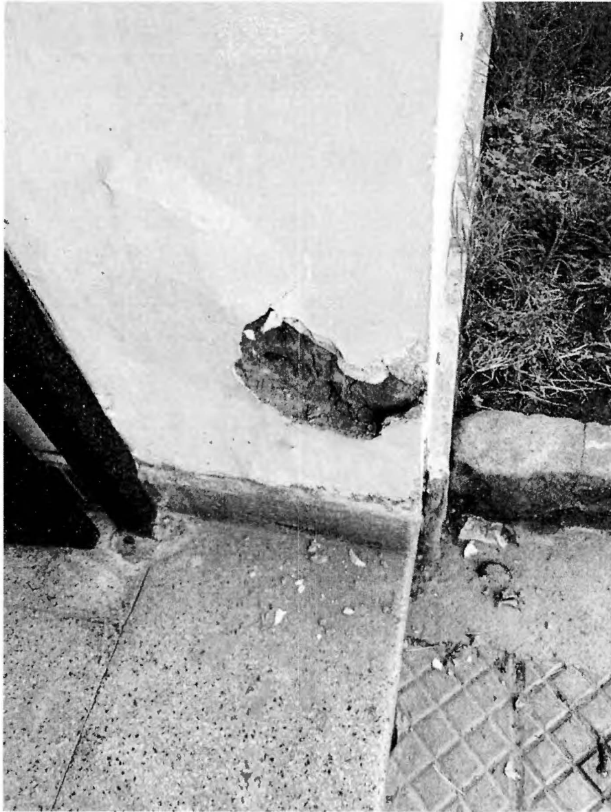
Figura 16: Desprendimiento de estuco en muro de acceso al edificio.
