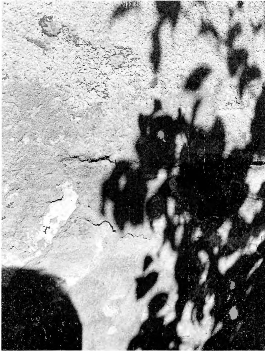
Figura 6: Desprendimiento de estucos y pintura en patio interior.
