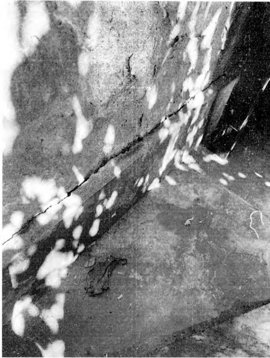
Figura 4: Daño inferior de fachada este, en patio interior
