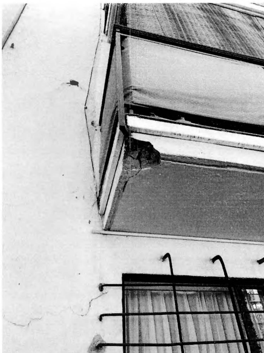
Figura 17: Fisuramiento y desprendimiento de estucos en muro y losa de balcones, respectivamente, fachada oeste.
