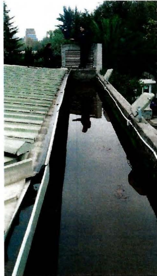
Jardinera en techumbre con aguas lluvias no evacuadas
