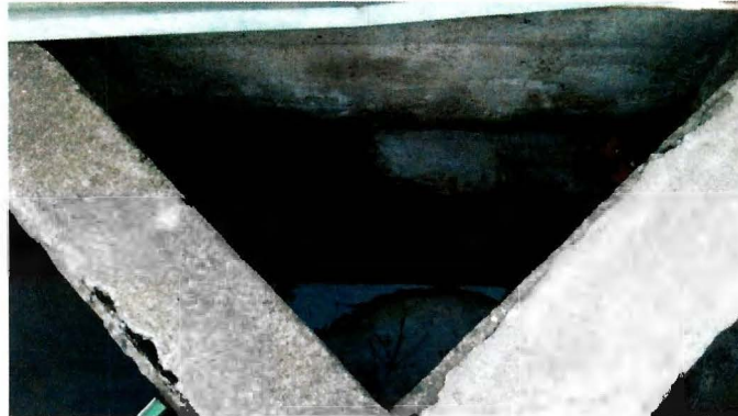
Cabezal de dos jardineras que unen evacuación de aguas lluvias desde jardineras a descarga vertical en pilar.
