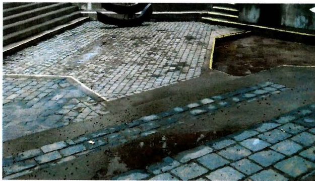
Estado de la plazoleta inferior horas después de una lluvia, señales y restos de anegamiento.
