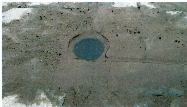
Pileta piso sin funcionamiento, no evacua aguas lluvias
