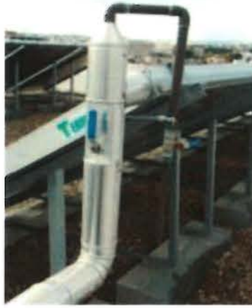
Figura 4. Purgadores de aire.
