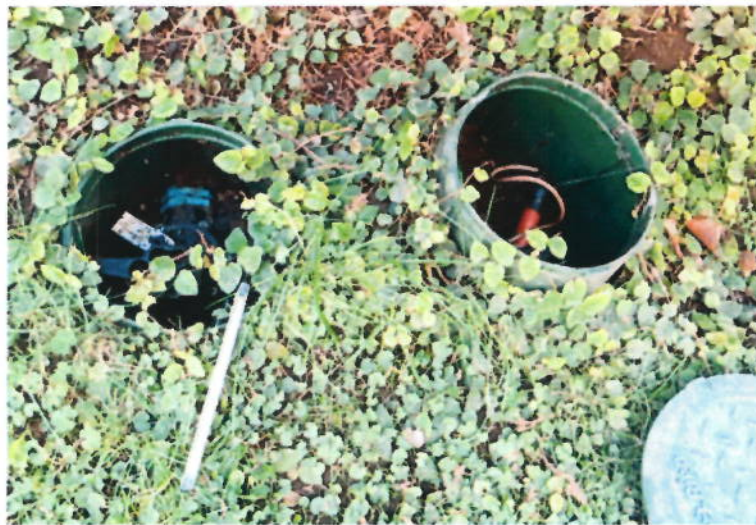
Cajas eléctricas y de válvula de sistema de aspersión
